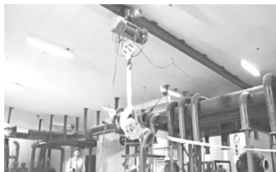
图7 机房行吊系统
