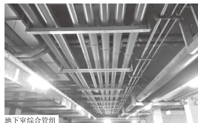
地下室综合管组
